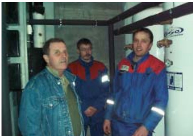
Einar Galde, Oddgeir Kilen og Jan Idar Øygard i samtale etter montering av maksimalvokteranlegg i Skjolden Hotell
