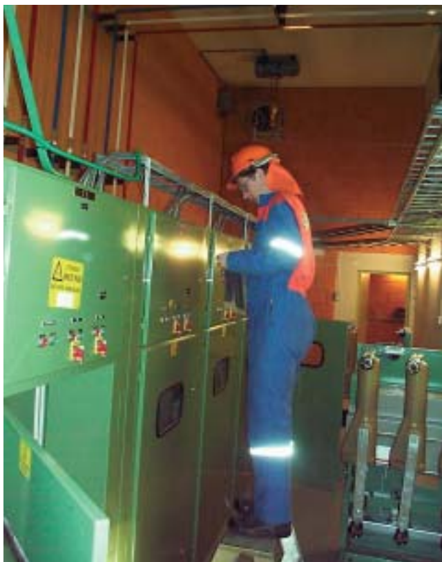
Montering av tovegskommunikasjonsutstyr i Leirdøla Foto: Hallgeir Hatlevoll
