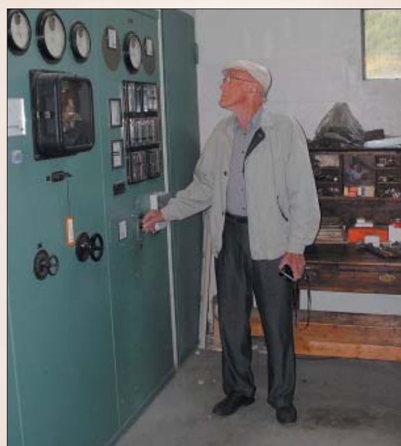
Stopp av gamle Sage Kraftstasjon 11.06.01. Foto Steinar Listou.
