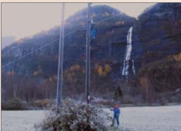
Strekking av ny jordlinje m/ fiber i Fortun. Foto: Hans Arvid Skagen.
